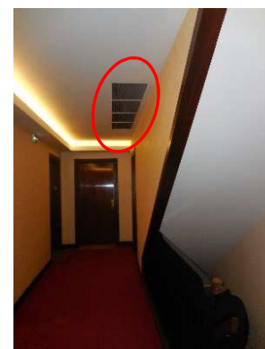
- Trappe de désenfumage -
